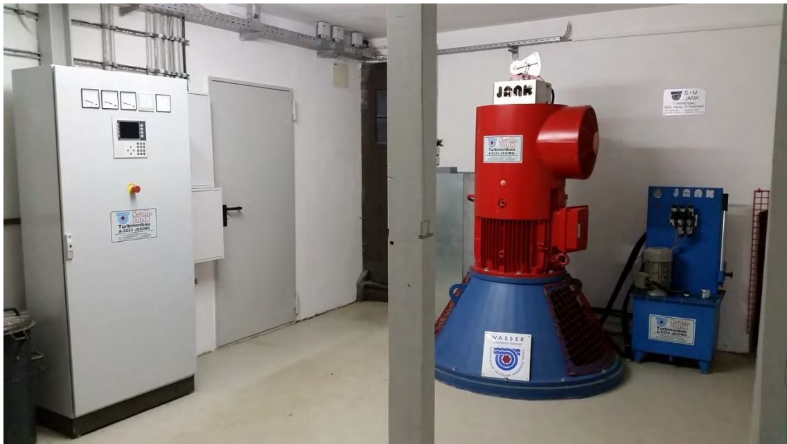
Abbildung 27: Turbinenraum des Wasserkraftwerkes der Mühle Antweiler [84]
