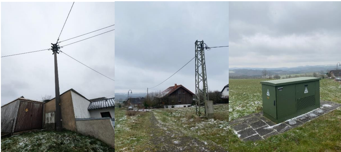
Abbildung 4: Stromnetz und Transformator bei der Vor-Ort-Besichtigung [eigene Darstellung]
